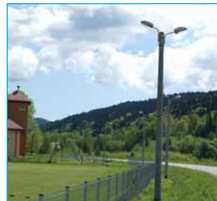
Oświetlenie uliczne przy drodze powiatowej w Królowej Górnej - 2014 rok, dofinansowanie z PROW 2007-2013 Odnowa i Rozwój Wsi. Koszt inwestycji- 96.662 zł.
